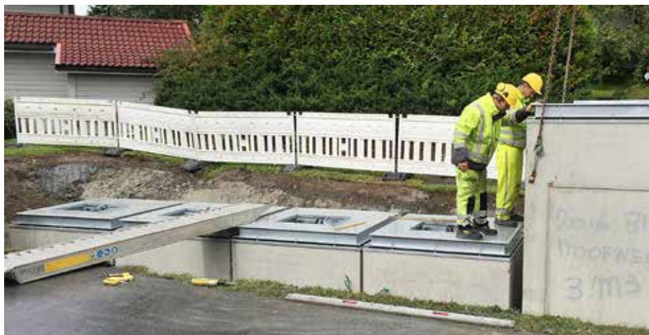
Den siste betongcontaineren settes på plass. Pga. den høye egenvekten kreves det ingen ekstra forankring.
